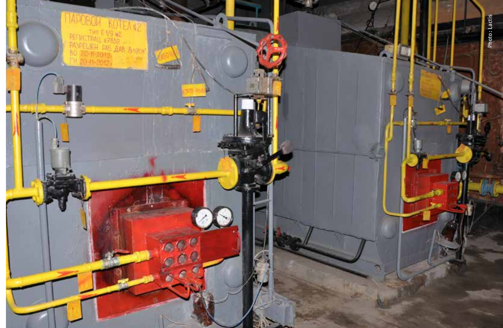
En réaménageant astucieusement les chaudières, il a été possible d'en éteindre une complètement.
